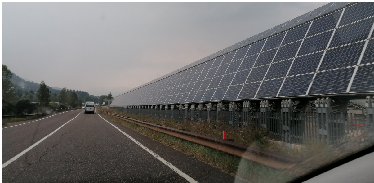
Installation solaire le long d'une autoroute d'Italie du Nord. (photos A. Mathey)
